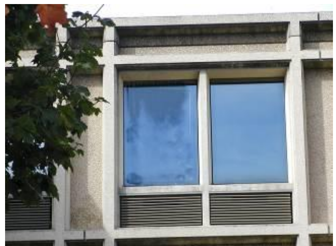
Destruction de la couche réfléchissante par des produits agressifs ( acide, basique ou abrasif).
